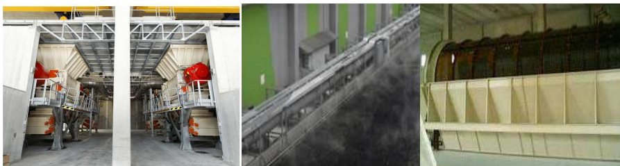
Fig. 12. Impianti di Trattamento Meccanico Biologico (TMB)
